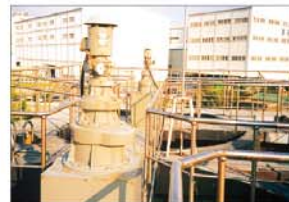
化學工廠刮泥設備
